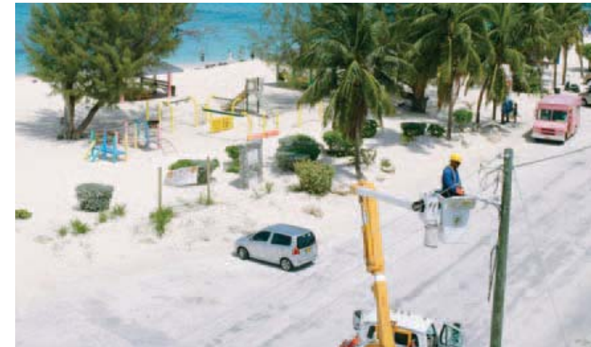
Caribbean Utilities possède et exploite environ 550 kilomètres de lignes de transport et de distribution, ainsi que 22 kilomètres de câbles sous-marins à haute tension.
