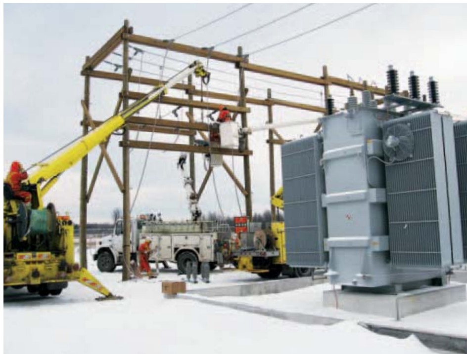
Une nouvelle sous-station de 1,4 million $ mise en service à Gananoque en 2007 a permis d'offrir un service plus fiable et plus sécurisé à la collectivité.
