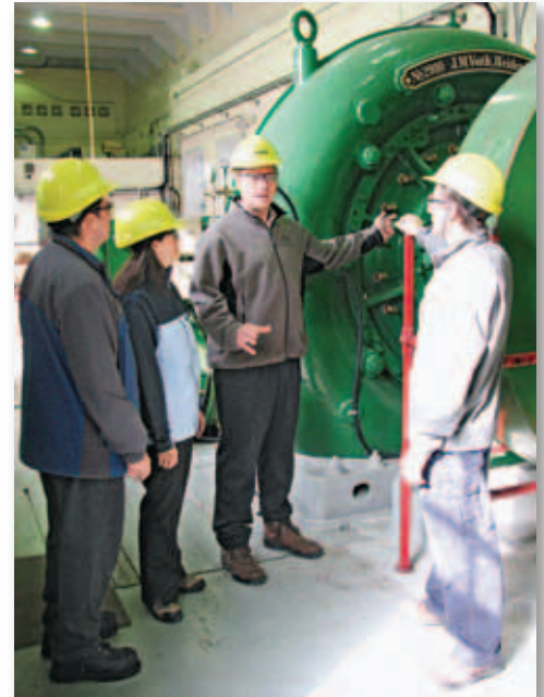
La centrale Petty Harbour, première centrale hydroélectrique de Terre-Neuve mise en service en 1900, a fait l'objet d'une remise en état de 1,8 million $ en 2006.
