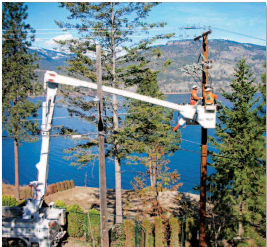
Les actifs de services publics de FortisBC comptent plus de 6 750 kilomètres de lignes de transport et de distribution d'électricité et quatre centrales hydroélectriques d'une capacité combinée de 235 MW.
